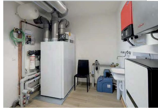
Die gesamte Haustechnik ist ebenerdig im auch von außen zugänglichen Hauswirtschafts-Raum untergebracht. Hinten links ist die Wärmepumpe mit Lüftungsanlage zu sehen, vorne rechts der Stromspeicher.
