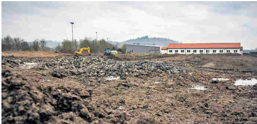
Noch Baustelle, bald der neue Standort von FingerTreppen: Das Unternehmen mit Sitz in Bottendorf zieht in die Nähe seines größten Kunden.
